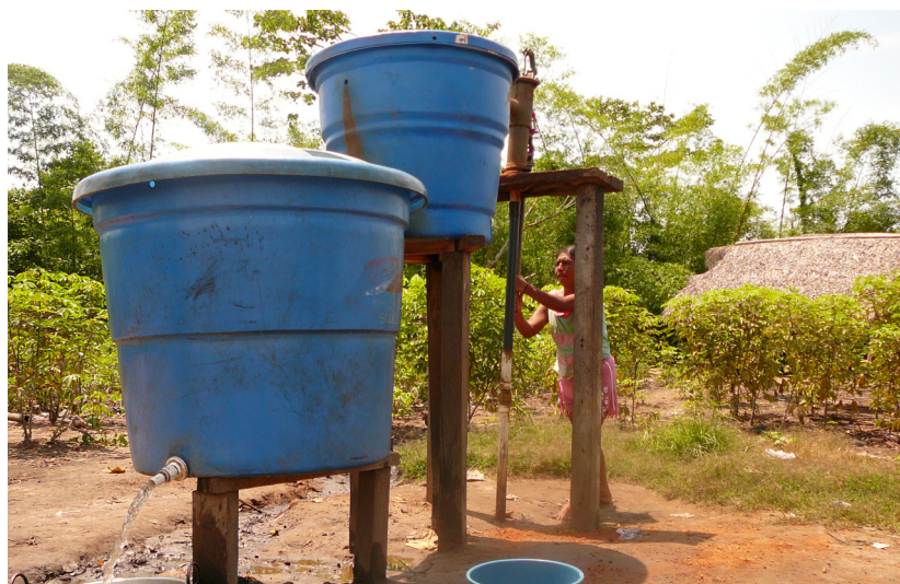
In Betoyes hilft der LWB, Zugang zu sauberem Trinkwasser sicherzustellen. © LWB/AWD-Kolumbien
